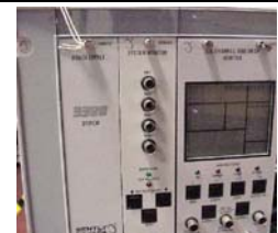
Controlador Bentley Nevada
